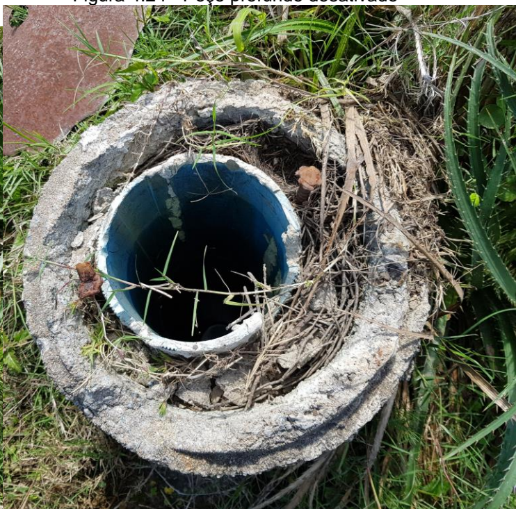
Figura 4.24 - Poço profundo desativado
