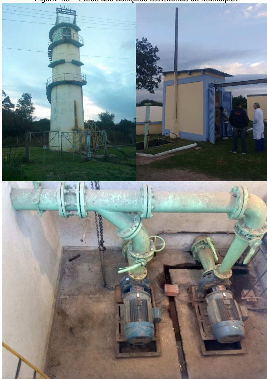
Figura 4.9 – Fotos das estações elevatórias do município.
