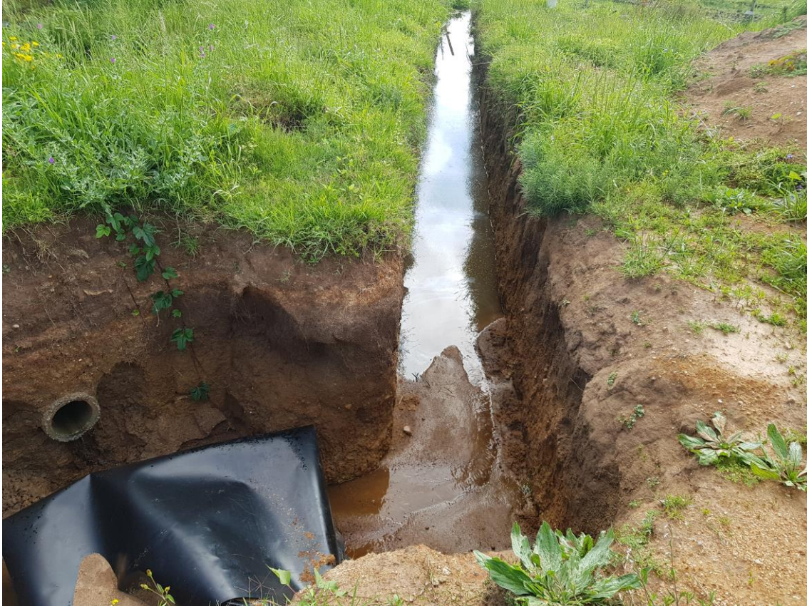
Figura 6.29 - Canal de drenagem que conduz água das lagoas para o terreno particular
