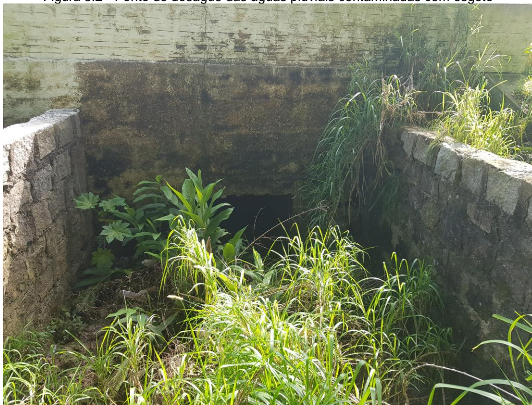
Figura 5.2 - Ponto de desague das águas pluviais contaminadas com esgoto
