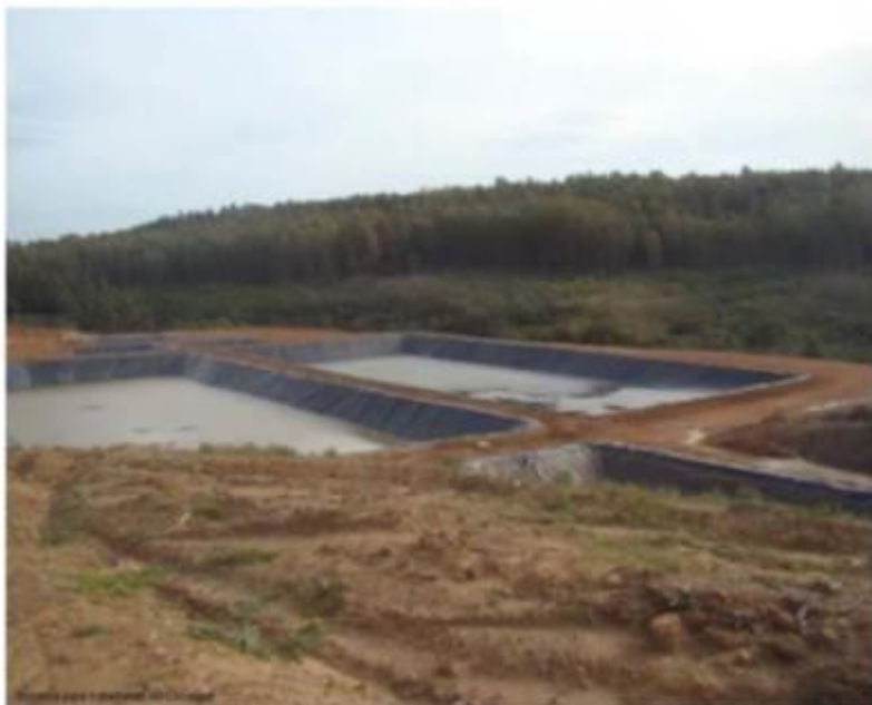
Figura 6.16 - Lagoas de estabilização para o tratamento de lixiviado no aterro sanitário Metade Sul - Candiota/RS
