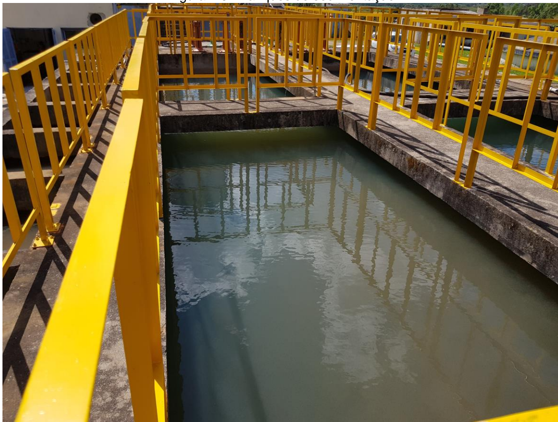
Figura 4.6 - Tanques de sedimentação
