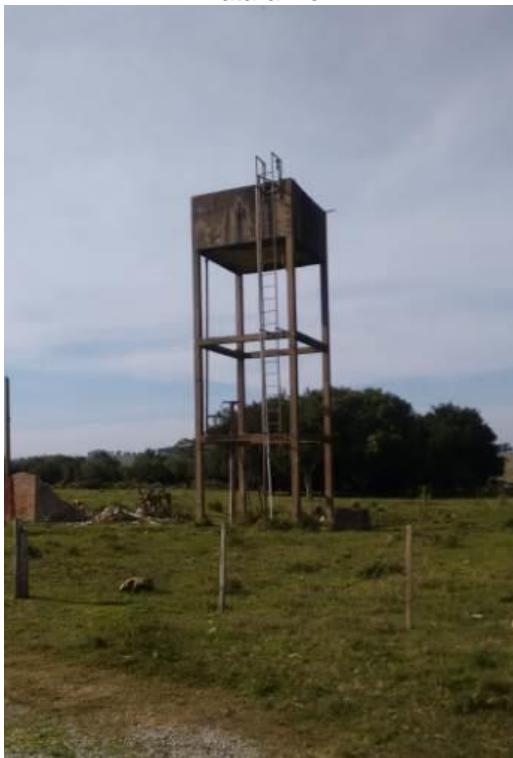
Figura 4.25 – Reservatório do Comunidade Matarazzo
