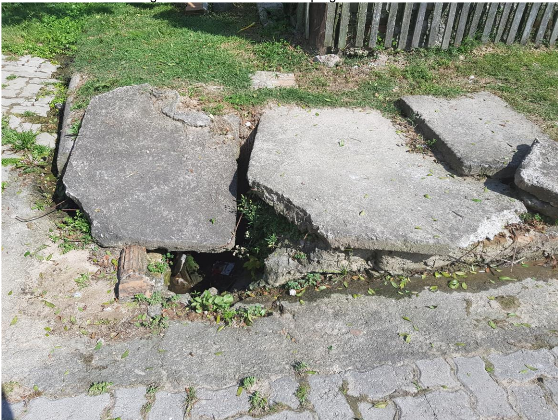
Figura 7.3. Boca de lobo do tipo guia nos bairros
