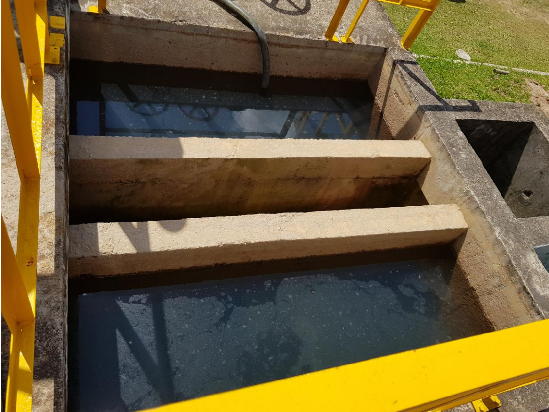
Figura 4.7 – Filtros da Estação de Tratamento de Água
